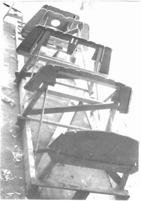
Les cloisons sont fixées sur le chantier. C'est l'un des stades où il faut être minutieux si l'on veut que le bateau soit droit.
